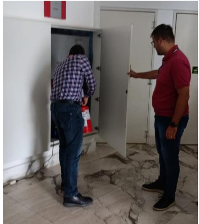
2- Central elétrica no Térreo.
