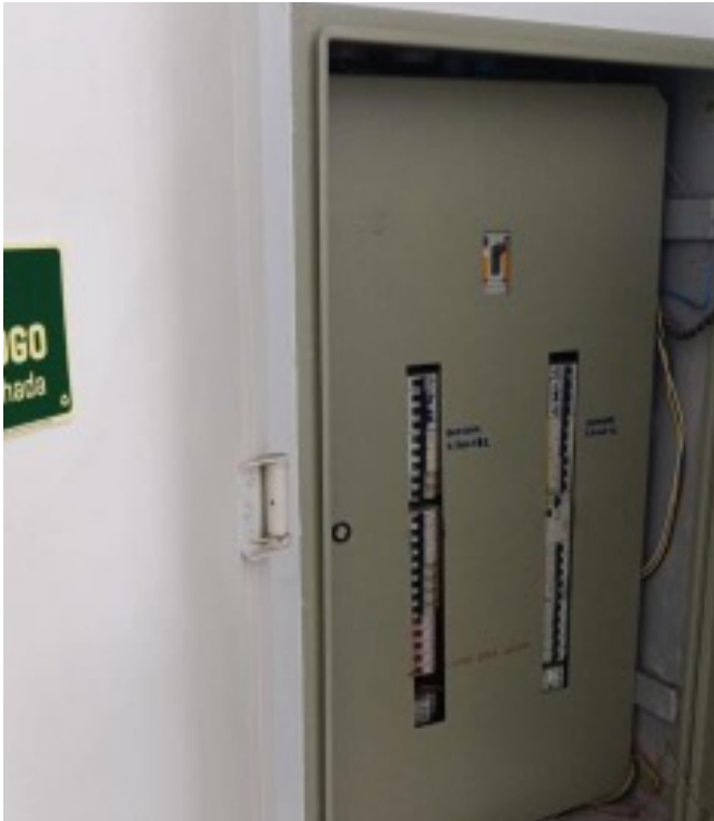
1- Quadro de energia elétrica.
