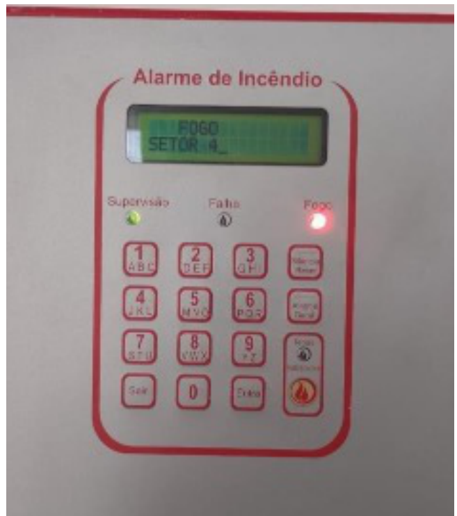
Central de alarme identifica o setor
