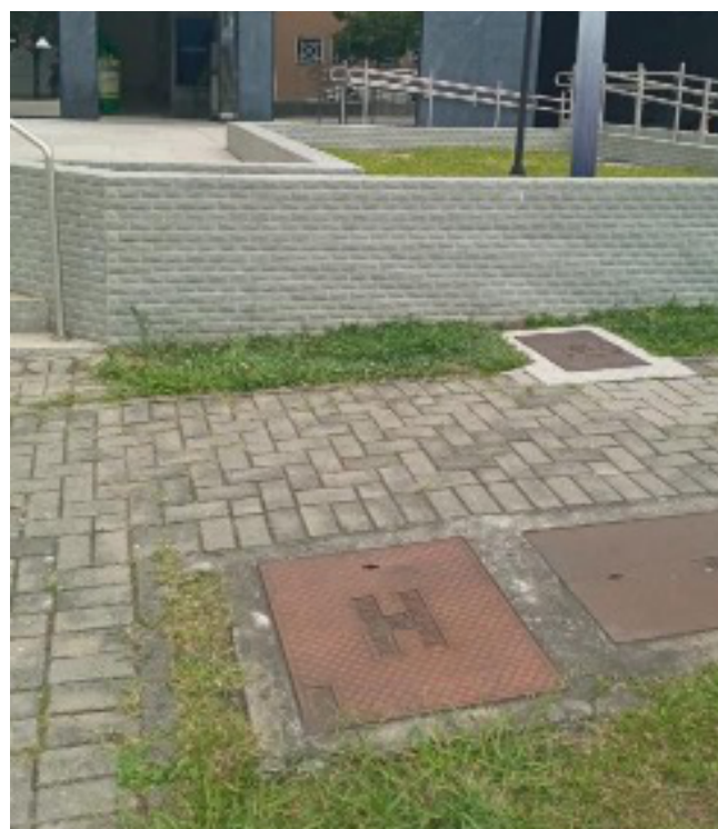
9 - Hidrante de recalque.
