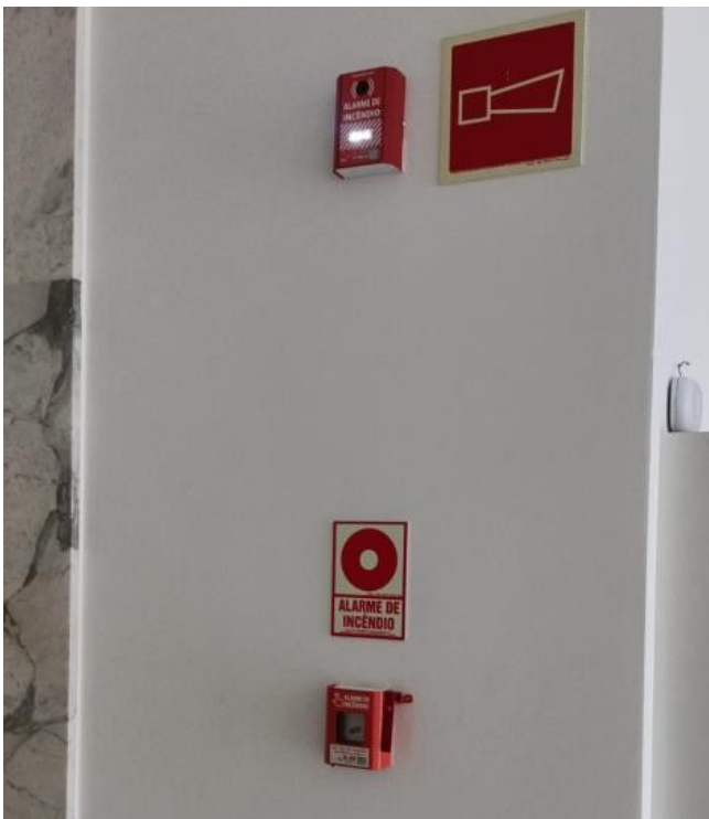
Alarme de Incêndio acionado
