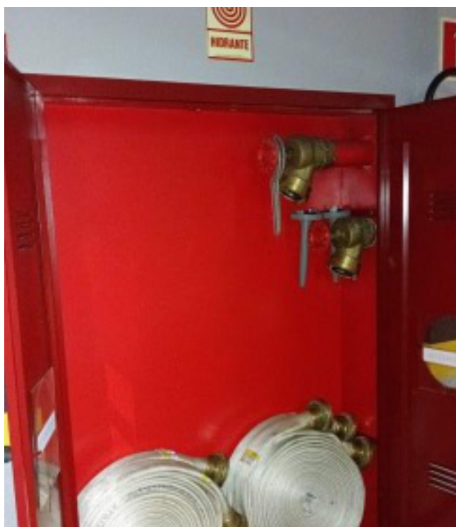
8- Hidrantes nos pavimentos.
